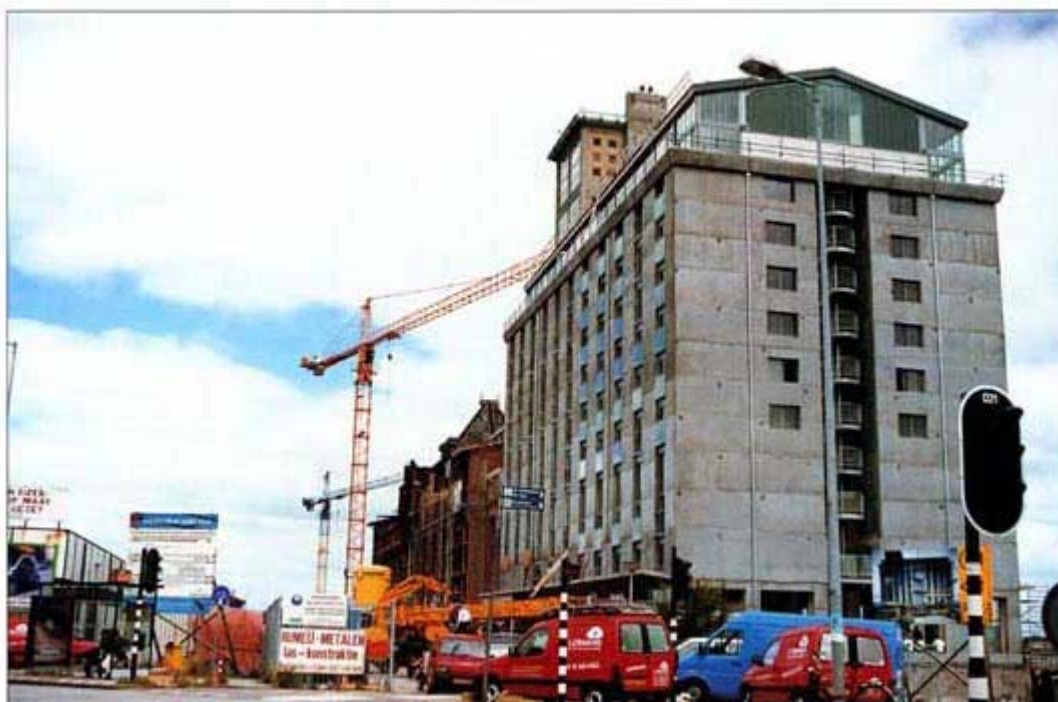
De werkzaamheden in de betonnen silo zijn bijna klaar. Op de bovenste verdieping komen "Penthouses" met fantastisch uitzicht over de stad.
